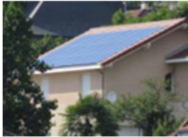
La Buisse - Maison Laurent 9kWc
