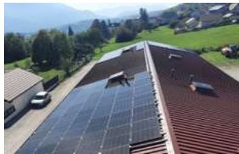
Miribel les échelles bâtiment technique 36kWc
